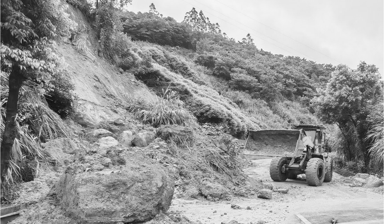
3 日，国道 355 线诗山镇鳌峰村附近路段突发边坡溜方险情。南安公路分中心快速响应、高效处置，第一时间清除路面障碍、恢复道路通行，全力筑牢雨天公路安全通行防线。
