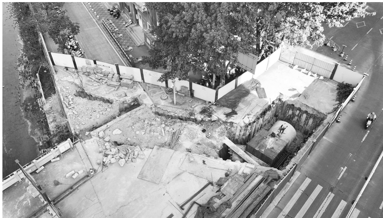
在溪美环城西路,工人正在进行雨水管道与箱涵交接井的浇筑施工。
