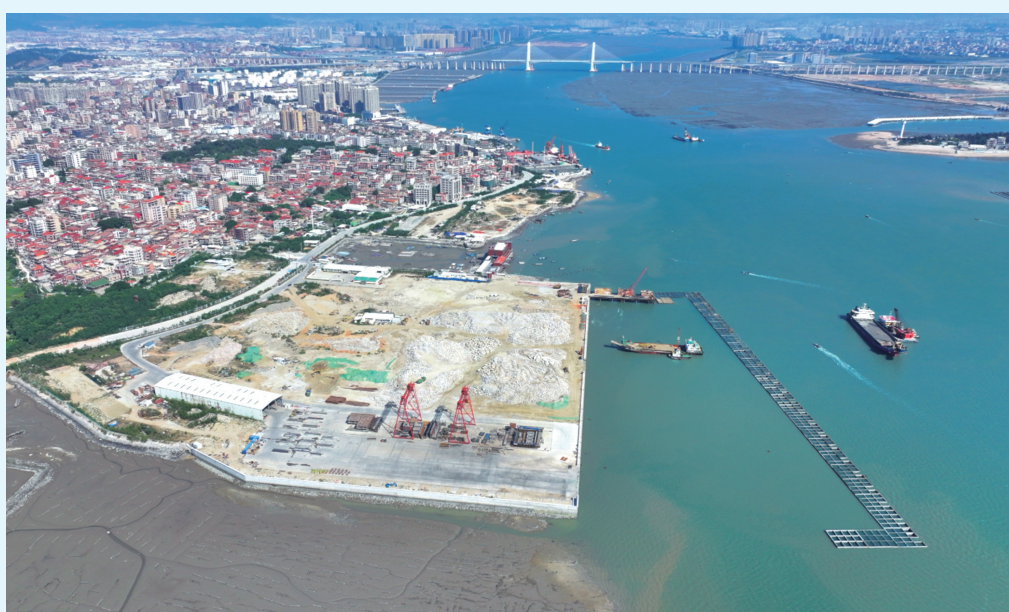
泉州港围头湾港区石井作业区11号、12号泊位工程沉箱安装顺利完成。
