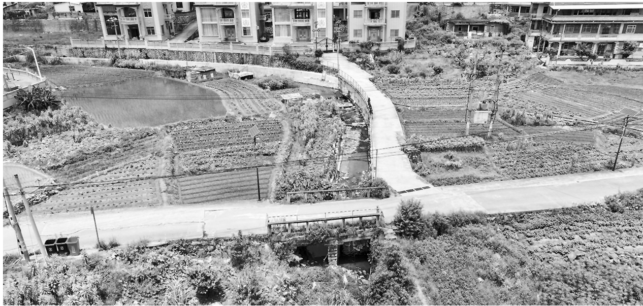
樟仔洋桥桥面断裂下沉,经鉴定为危桥。
