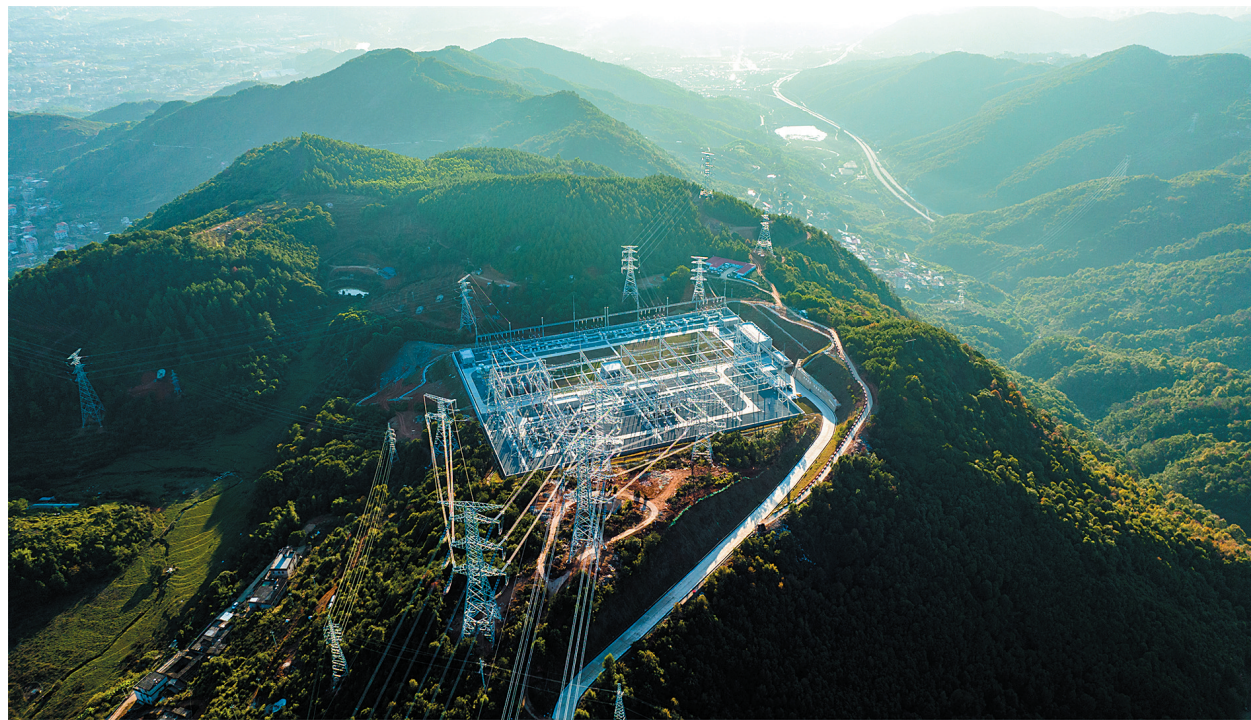
南安市第二座500千伏变电站投运,为经济发展注入充沛电能。
