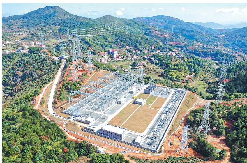
位于眉山乡的洋荷500千伏输变电工程。
