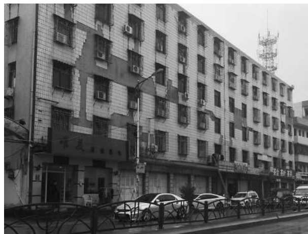
外墙瓷砖原本脱落严重。
